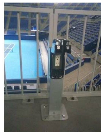
<電動車いす充電用コンセント>
