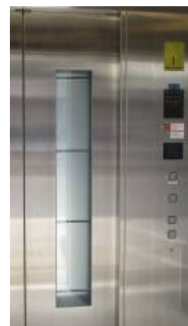
＜エレベーター＞
