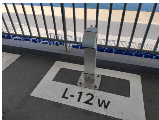
<電動車いす充電用コンセント>
