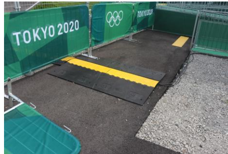
2 ケーブルカバー（仮設）
