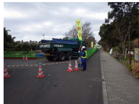
写真 6.8.4-8 園内安全対策
