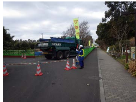
写真 6.8.8-4 園内安全対策
