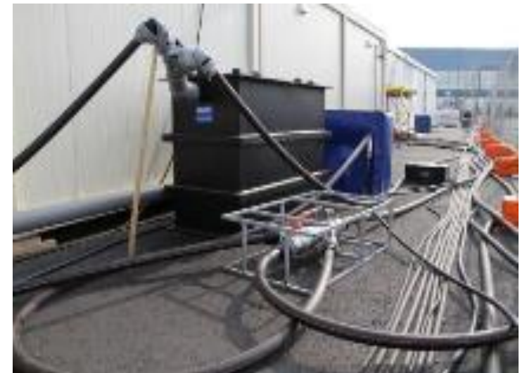
レンタル・リースによる 仮設給排水システムの設置事例
