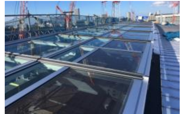
ガラス面に設置した太陽電池
