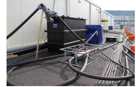
仮設給排水システム
